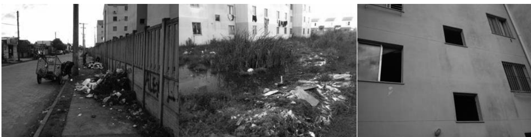
Figura 5. Acúmulo de lixo externa e internamente ao Jardins do Obelisco (E e C) e furto das esquadrias nas áreas de uso comum (D). Fonte. Os autores.
